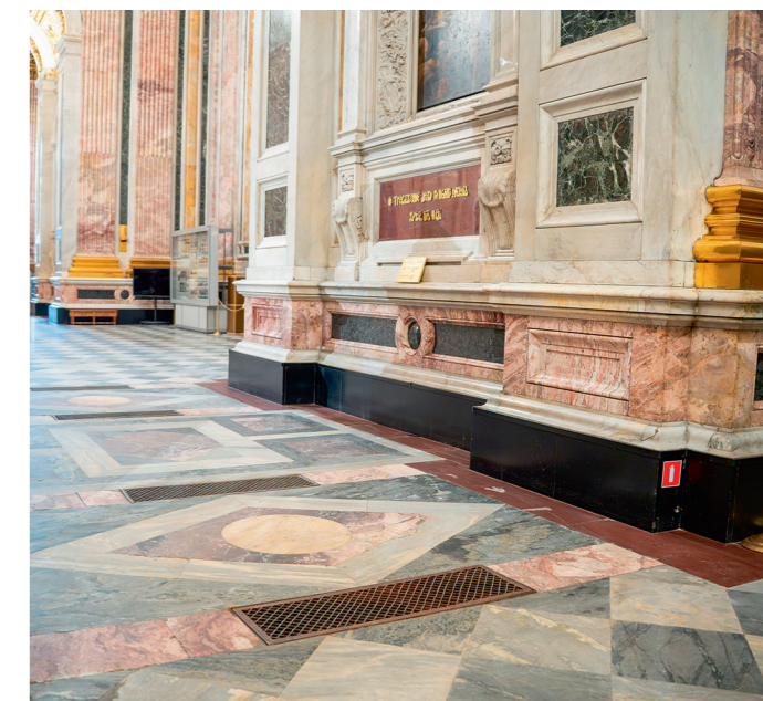
Вентиляционные решетки в полу, через которые идет теплый воздух
